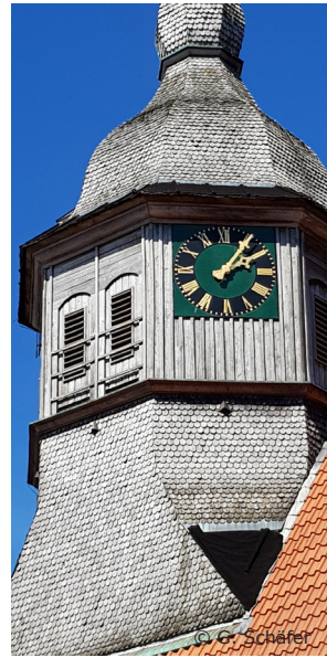
Marode Holzschindeln am Glockenturm
